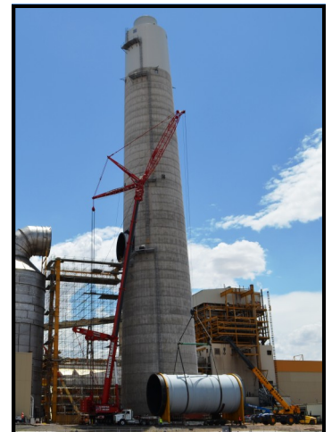
Coronado Generating System, AZ
